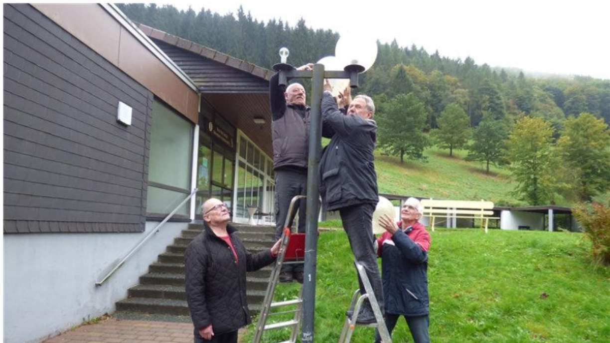
Jörg Rögener, Hans-Herman Koch, Bernd Füllgrabe und Dr. Jürgen Grove erledigten die letzten Arbeiten an den Lampen. Foto: Paul Beier
